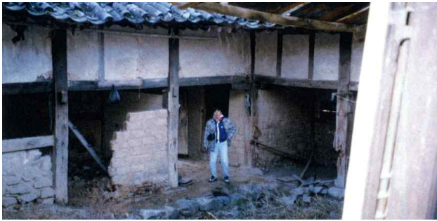
Fig.4 수리 전 상부 다락의 벽과 문얼굴
