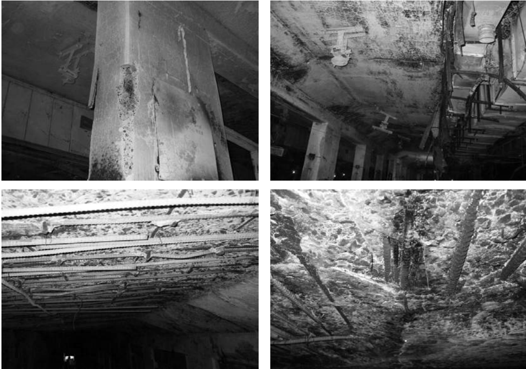
사진 2.5 중앙로 역 화재피해 현장
