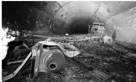
사진 2.1(b) 달성터널 화재 발생 후
