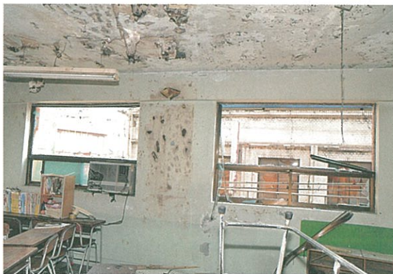
[사진 1] LNG 확산 폭발 현장 중, 하단부에서는 열변형 흔적이 발견되지 않는다.
