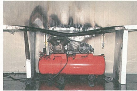
[그림 12] 공기압축기의 연소 후 상황
