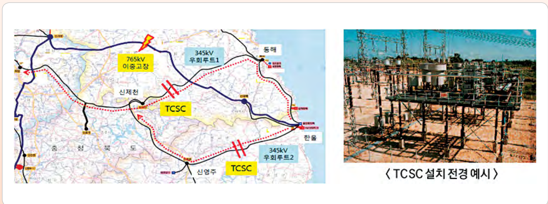
그림 7 TCSC 적용위치 및 설치 전경
