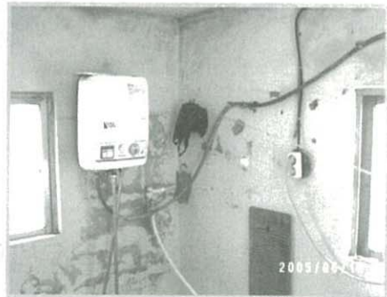
[세면장에 설치된 온수기]
