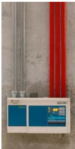
벽면에 설치된 능동형 강제 흡입 화재감지기
