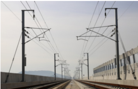
그림 1 호남고속선 장력조정장치 설치 사진
