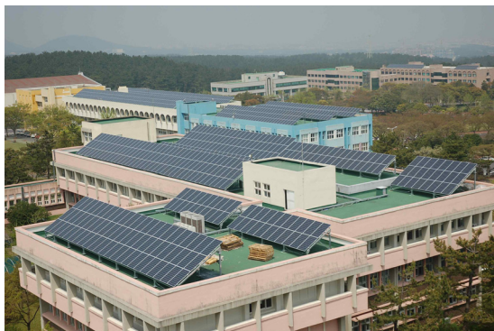
그림 2 태양광발전소 일부 에레이 배치 전경 Fig. 2 View of some arrays in the PV plant
