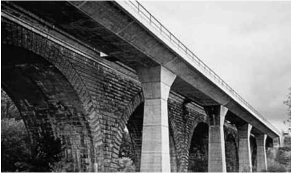
〈21a. 낮은 철도 고가교를 현대적 고가교로 보완하고 있다. 다경간 일체형 라멘교와 고전적인 아치교와의 현대적 종합, 신교와 구교의 시간장은 동일하다. 기존 교량을 참조한 구조와 구성〉
