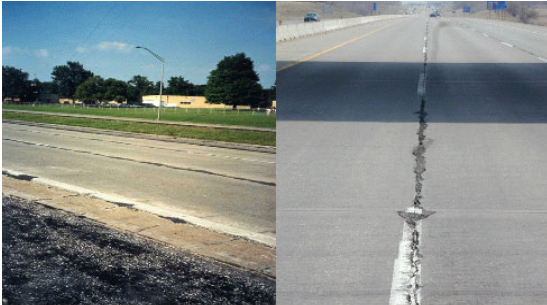
그림 4. 줄눈부 스폐링 발생 전경
