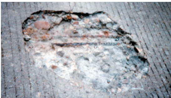
그림 7. 철근배근 상승으로 인한 포장 파손
