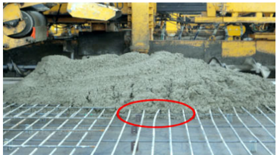
그림 5. 콘크리트 타설 시 철근변형 전경(Texas, USA)
