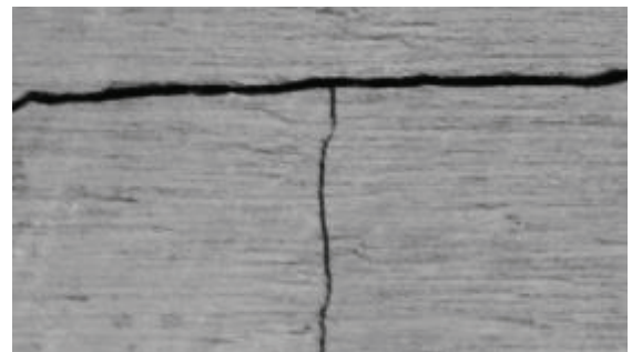
Fig. 6 콘크리트 균열 사진
