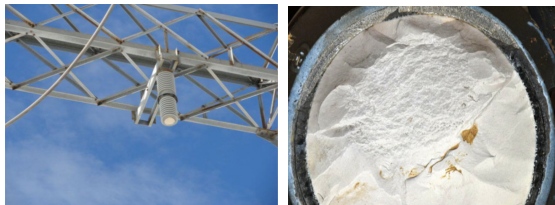
그림 2 파손된 애자 Fig. 2 Broken Insulator
