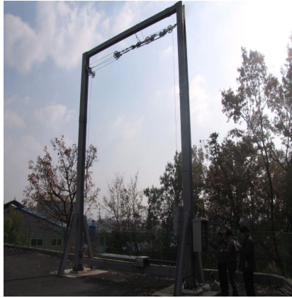
그림 6 장력조정장치의 작동 및 과부하시험장치 Fig. 6 Testing facility for operating and overload tests for the pulley type tensioning device
