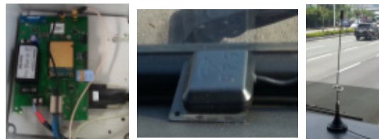
그림 11. 스마트포인트 및 안테나 설치 Fig. 11. Installing Smart Point and antennas
