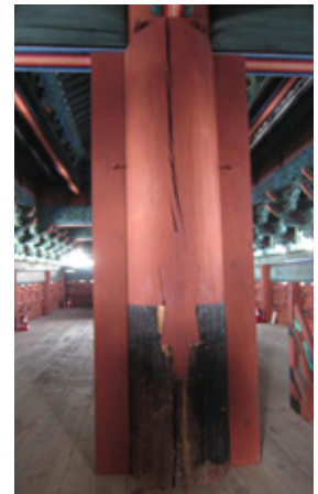
(d) Column splitting on 2 nd floor
