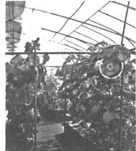
> 고압포그시설 및 환기팬
