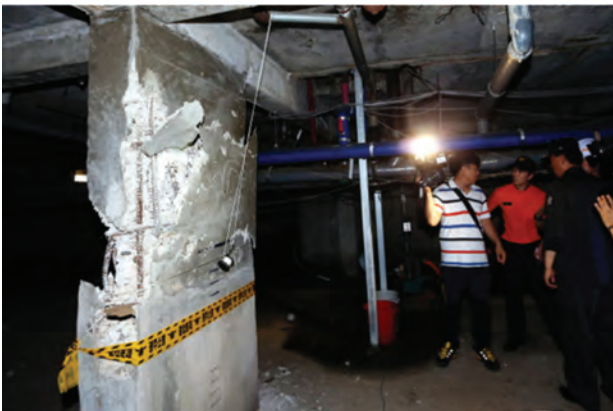
[그림 3] 광주 아파트 지하층 기둥 균열 사고
