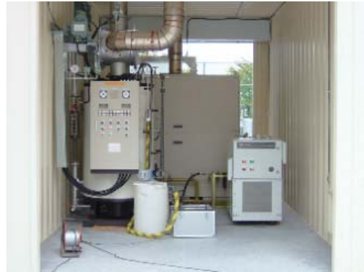
대전 GS칼텍스에 설치된 MGTCHP 실증시험 현장
