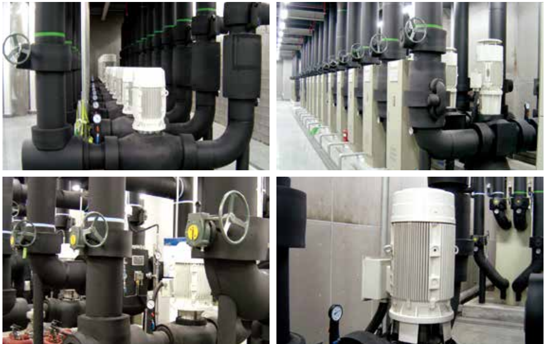
[그림 11] 펌프류 설치 현황
