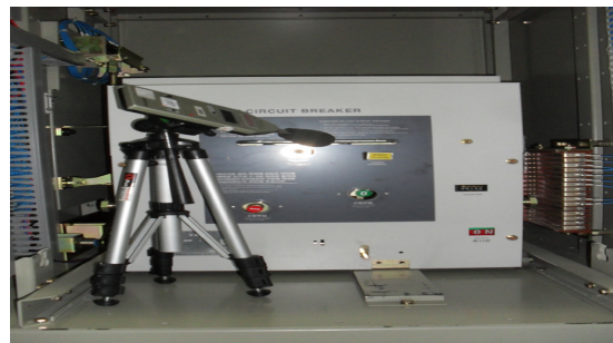
그림 4. 차단기반 내부 소음 측정 Fig. 4 VCB cubicle inside noise measurement
