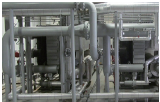
[그림 6] 설치된 흡수식 냉동기 전경
