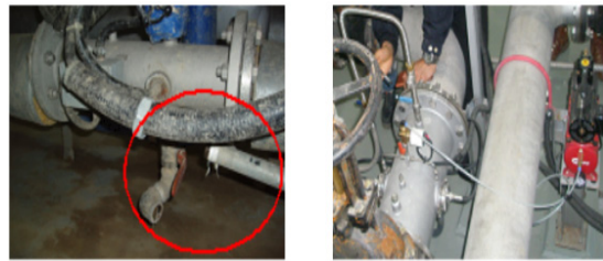
그림 2. 드레인배관 막힘현상과 교정을 위한 청수라인 Fig. 2 Stopped drain pipeline and clear water pipeline for correction
