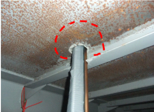
[그림 2] 차폐실 천정을 뚫고 설치된 전선
