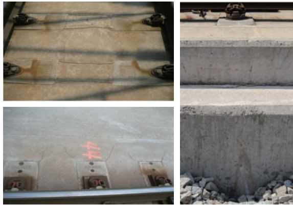
(a) 콘크리트 도상(궤도 슬래브)와 기층의 균열
