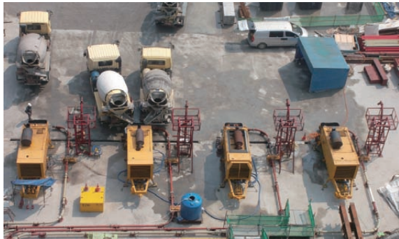
(a) 고압 펌프 배치 전경
