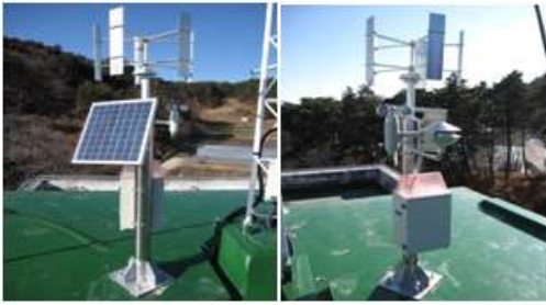
그림 16. 5층 옥상에 설치된 개발 시스템 모습 Fig. 16 Photos of the Developed System Deployed on the Roof of a 5-storied Building
