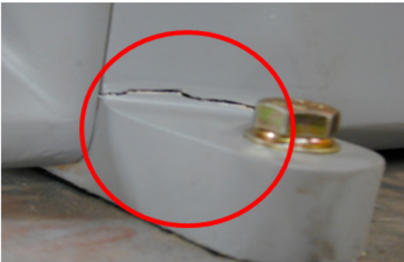
그림 8 파손된 기초고정부 Fig. 8 Damaged part of foundation
