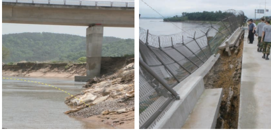
(a) 저수호안 침식 (b) 제방 시설물 파손
