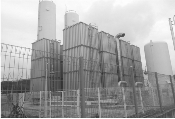
Fig. 2. LNG Storage Tank(outdoor)
