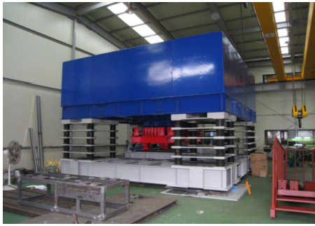
(a) P사 사옥에 설치된 TMD(횡방향 진동제어용)
