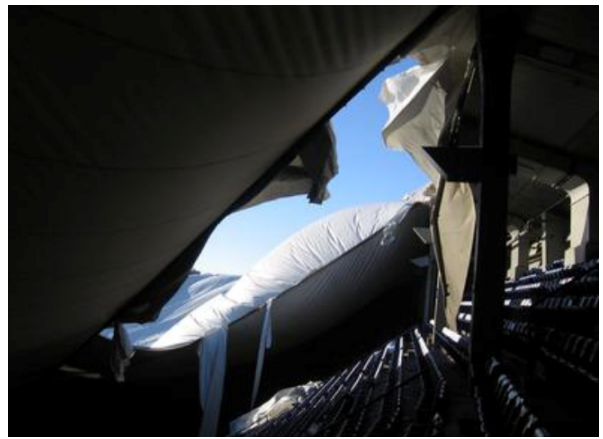
〈그림 3〉 험프리 메트로돔 지붕 파손사진
