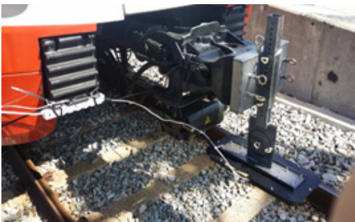
그림 5. 리더 설치사진 Fig. 5 Picture of reader installation
