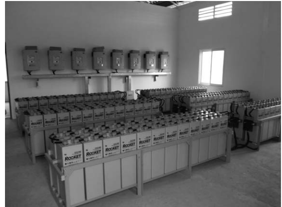
그림 5 해외 독립형 태양광 발전시스템의 Battery Bank
