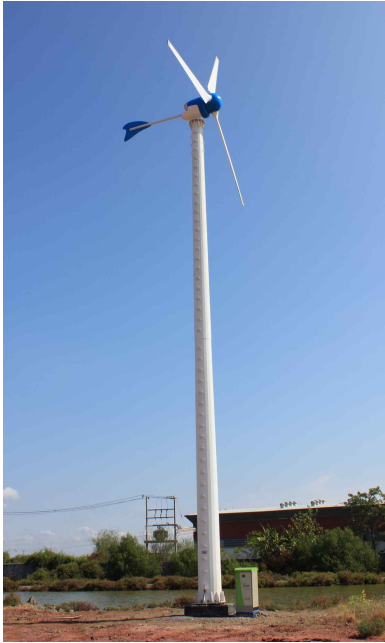
그림 14. 10kW 풍력시스템 Fig. 14. 10kW Wind Turbine
