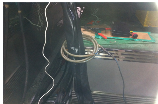
그림 9 인버터 출력의 케이블 차폐 Fig. 9 Cable shield of inverter outputs
