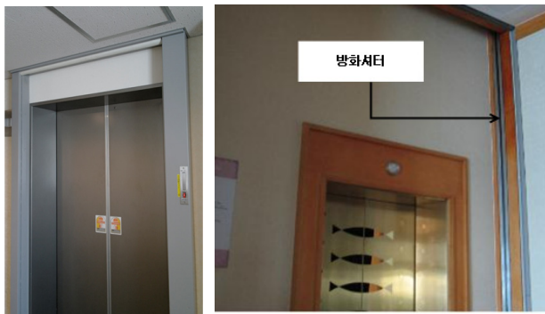
(좌 : 스크린 방화셔터, 우 : 철재방화셔터) 그림 3. 엘리베이터 승강장 방화셔터
