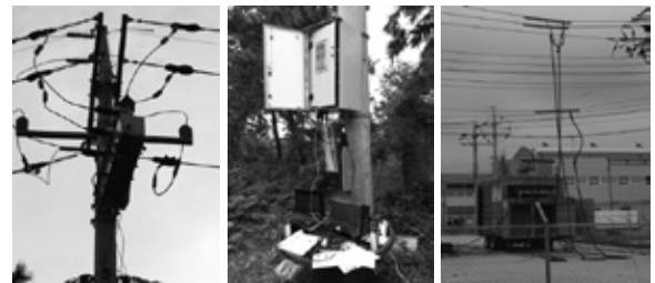
[그림 7] Pulse Recloser 본체 · 제어함 및 AFG (고장발생장치) 설치
