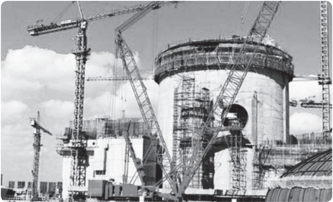
중국의 원전 건설 모습. 중국 정부가 신규 원전 건설 추가 승인 보류 정책을 철회한 이후 푸칭(Fuqing) 4호기, 시다오완(Shidaowan) 1호기, 티안완(Tianwan) 3호기, 그리고 양장(Yangjiang) 4호기 등 4기의 원전이 건설 승인을 받았다. 이에 따라 현재 중국에서 건설되고 있는 원전은 모두 29기에 이른다.
