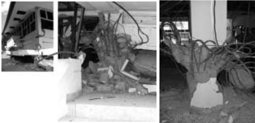
그림 10. 부적절한 횡철근 사용에 의한 기둥 전단파괴 후 압축파괴, 인도네시아 지진
