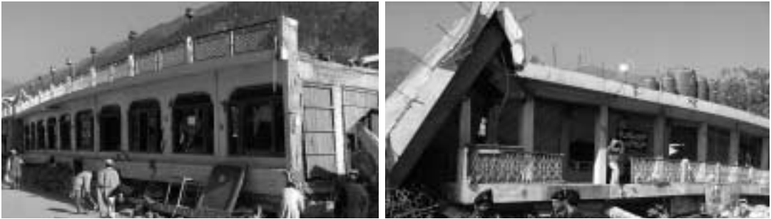
그림 15. 연약층(soft story)에 의한 1층 붕괴, 파키스탄 발라코트 거리
