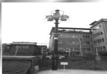
저압선로 전력공급용 변압기를 강관주에 설치, 케이블은 강관내부 설치
