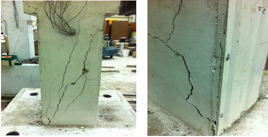
〈Fig. 9〉 Crack patterns (B2-1)
