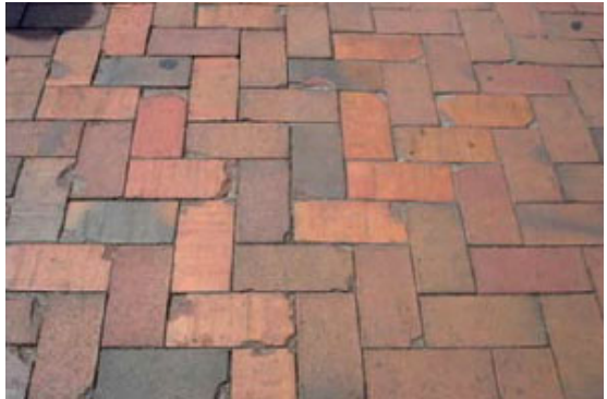
그림 3. 점토바닥벽돌의 포장 후 모서리 깨짐현상
