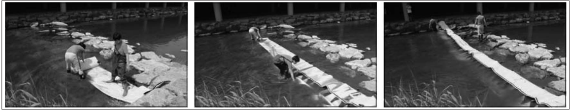
그림 11. Pocket Dam 설치
