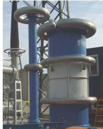
사진 1. 전원장치 Photo 1. Power Supply
