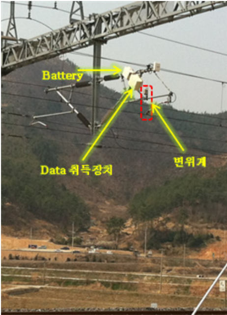
그림 8. 전차선 압상량 검측 장치 설치 사진.
