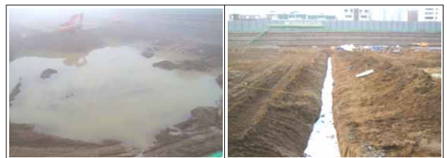
a) 사업장 B 수질오염방지시설 개선 전(좌)후(우)
