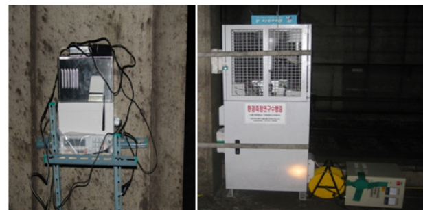
그림 6. 터널에 설치된 공기질 측정 장치 Fig. 6. Air quality measurement apparatus set up in tunnel.
