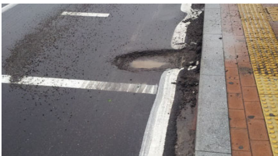
(a) 버스 정차대의 포트홀 파손
